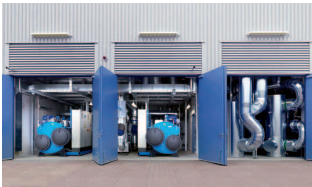
Blick in den Maschinenraum mit den Quantum Wärmepumpen.
