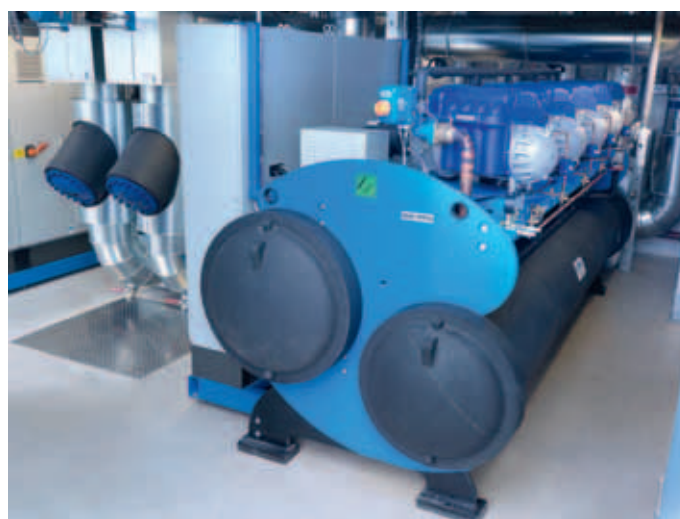
Macht effizientes Heizen möglich: eine Quantum Wärmepumpe hier mit 5 ölfreien Verdichtern.
