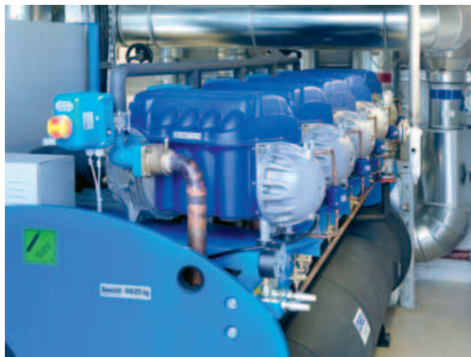
Die Nennkälteleistung der Quantum Wärmepumpe beträgt 1.420 kW, die Wärmeleistung je 1.807 kW.
