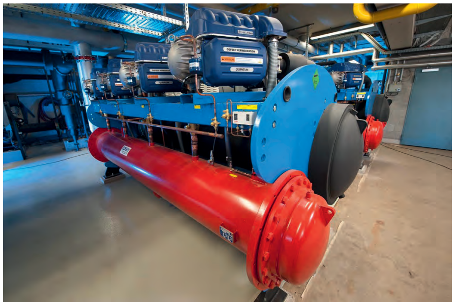
Abbildung 2: Moderne, energieeffiziente Kältemaschinen sorgen im Rechenzentrum für Ausfallsicherheit.
