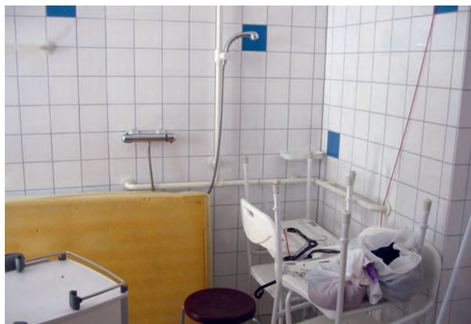
Fehler Betriebsführung: Seniorenheim: nicht bestimmungsgemäßer Betrieb, legionellenbelastet. (Werkfoto KRYSCHI).
