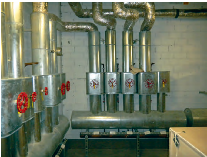
Planungsfehler: Krankenhaus: Feuerlöschleitung nass, unmittelbar an Verteiler Trinkwasser (kalt) in Technikzentrale mit Wärmelasten angeschlossen, legionellenbelastet. (Werkfoto KRYSCHI).
