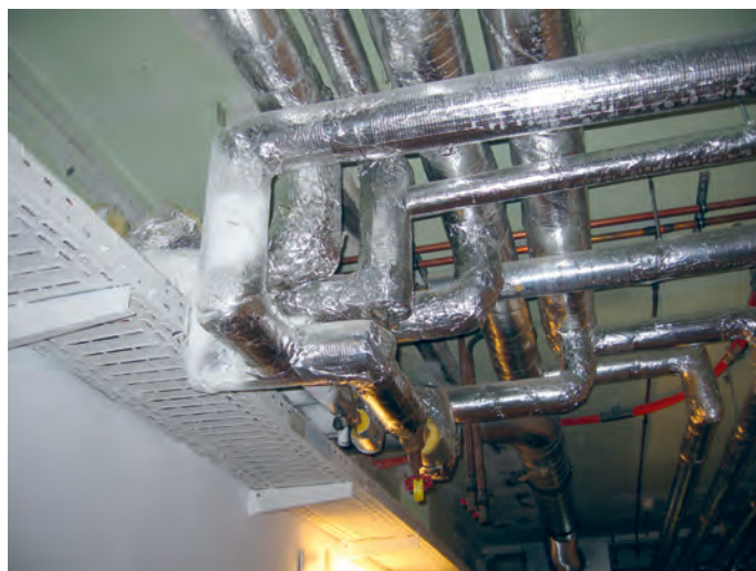
Planungsfehler: Krankenhaus, legionellenbelastet: Verzweigte Verteilung Trinkwasser. Hydraulischer Abgleich nicht möglich. (Werkfoto KRYSCHI).
