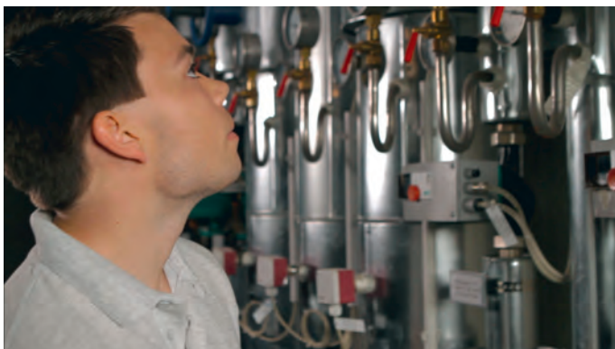
Abbildung 1: Auszubildender vor einem (Heizungs-)Verteiler der Wärmeversorgung im Stadion.
