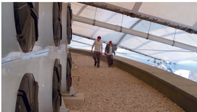
Abbildung 3: Auszubildende vor einem Rückkühlwerk auf dem Dach des Stadions.
