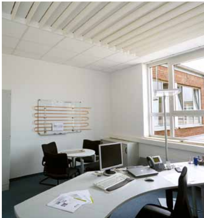
Abbildung 3: PCM-Hybridkühldecke in einem Büroraum, Quelle: Krantz Komponenten.
