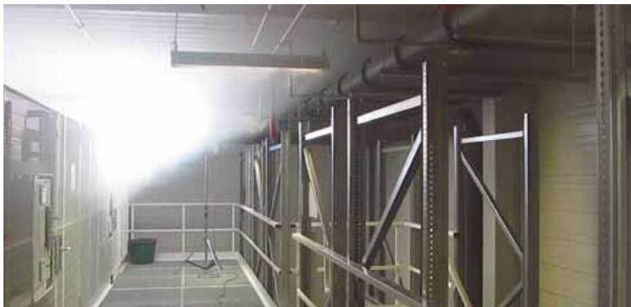
Abbildung 6: Brandraucherfassung an der Westwand des Lagers.
