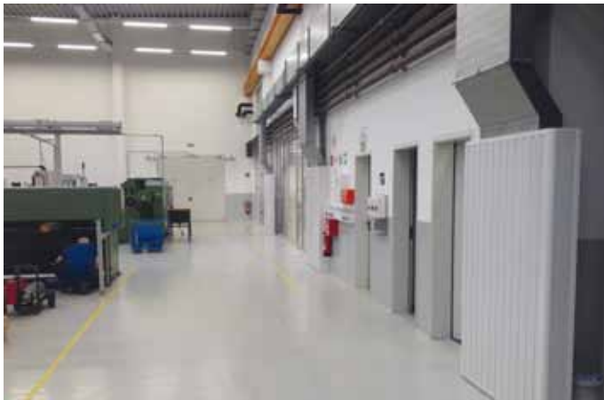
Abbildung 2: Produktionshalle mit Quelllüftung.
