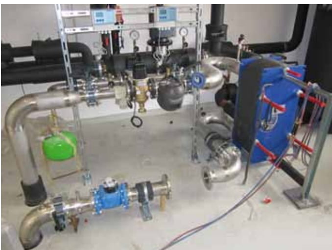
Abbildung 6: Plattenwärmübertrager mit Brunnenwasserseite.
