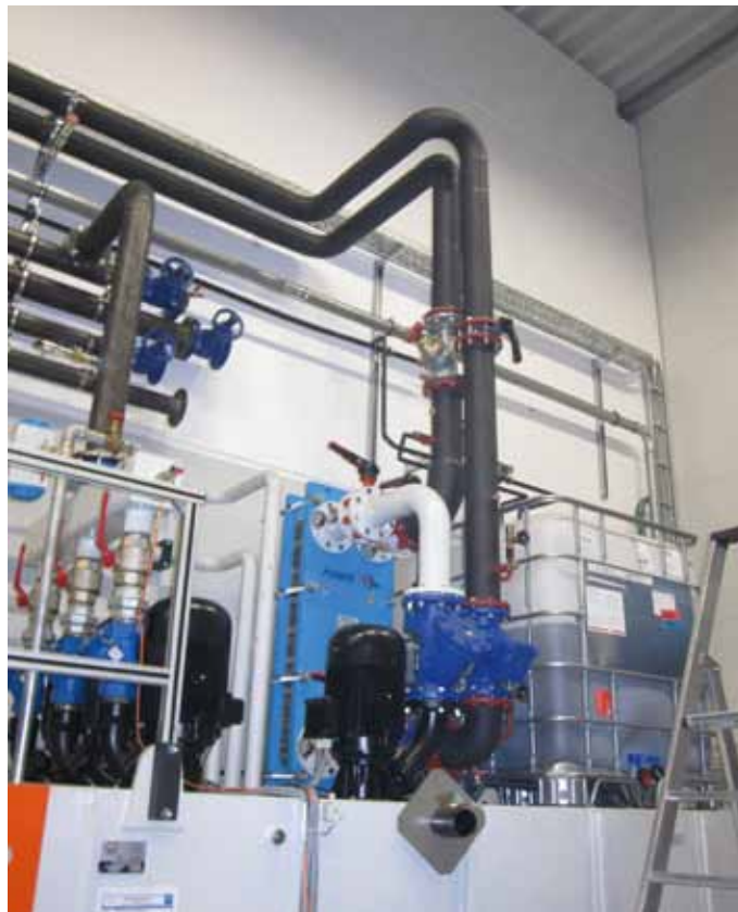
Abbildung 1: zentrale Kühlschmierstoffauf- bereitung
