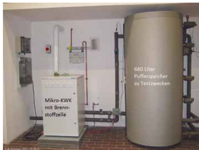
Abbildung 1: Versuchsstand des erdgasbetriebenen Brennstoffzellen-Mikro-KWK-Gerätes „BlueGEN“ der Firma Ceramic Fuel Cells GmbH. Hersteller-Angaben: elektrische Leistung P_{el, Export} 500 - 1500 W, thermische Leistung \Phi_{th, Export} 300 - 540 W. Heizungslabor der Fachhochschule Köln am Institut für Technische Gebäudeausrüstung.
