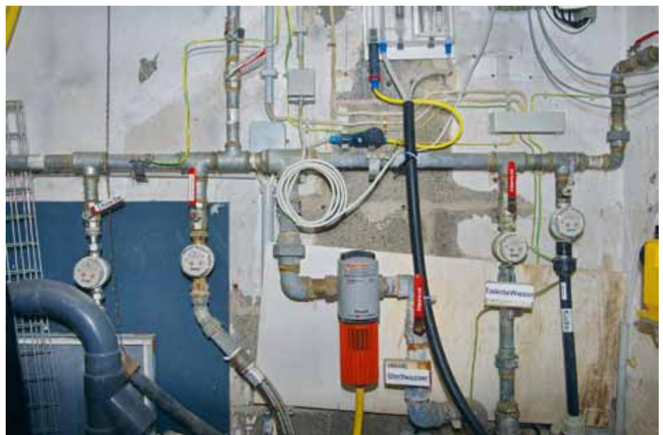
Bild 1: Nicht normgerechte Trinkwasser-Installation mit hohem gesundheitlichen Gefährdungspotential.
