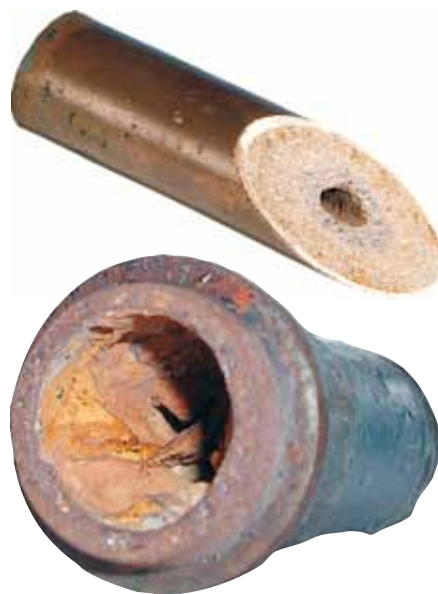
Bilder 2 und 3: Verkalkte und korrodierte Rohre stellen mit ihrer zerklüfteten Oberfläche eine ideale Brutstätte für Keime dar.
