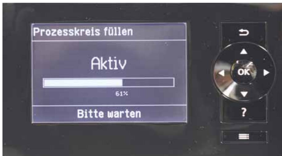
Bild 6: Inbetriebnahmeassistent im Einsatz.
