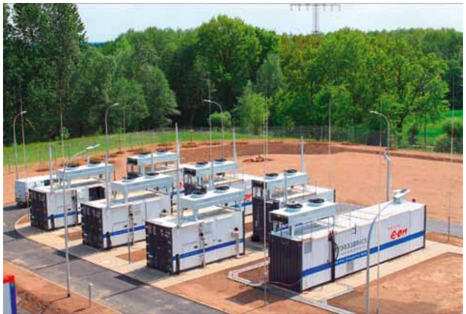
Bild 8: Power-to-Gas-Anlage der E.ON in Falkenhagen [58].
