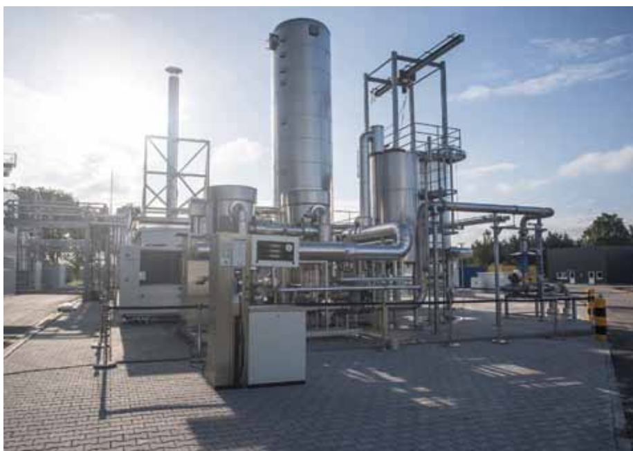
Bild 6: Ansicht der e-Gas-Anlage Werlte zur Erzeugung von Methan aus Windstrom.
