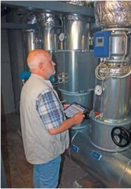
Abbildung 2: „AXI.COS SmartOperating“ bietet zahlreiche Möglichkeiten für die Überwachung und Steuerung.
