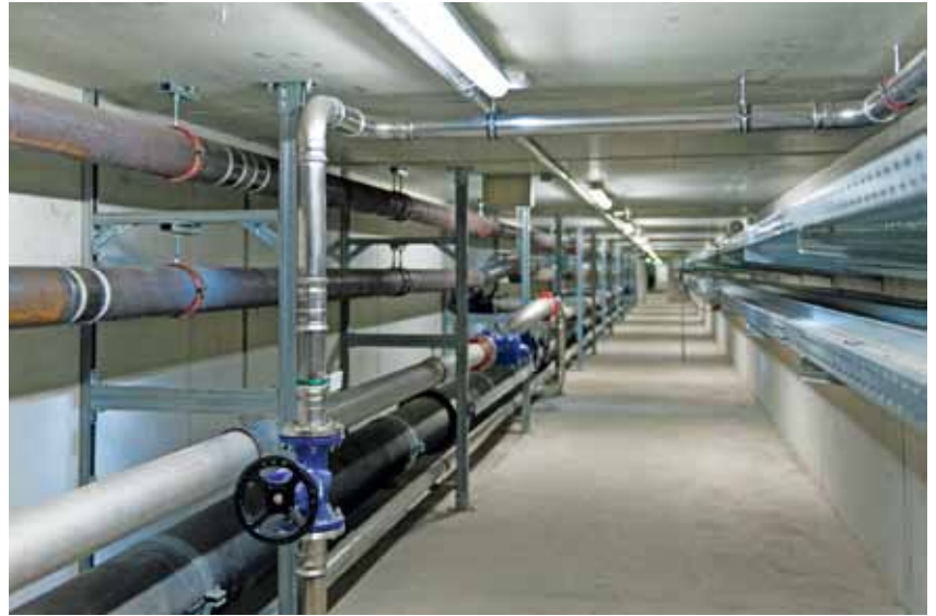
Versorgungsgang Halle 3A.
