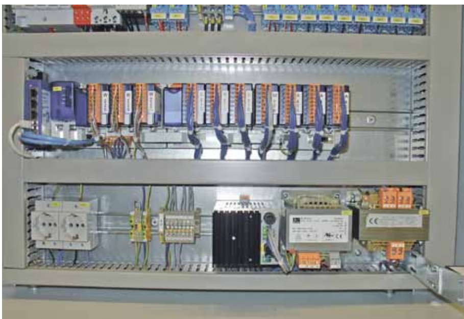
Bild 6: Der Power-Controller PCD3 verfügt über genügend Systemressourcen, um bis zu 13 Schnittstellen in einem Gerät zu betreiben. © Stefan Bäuning - ETM Energie Time Management GmbH
