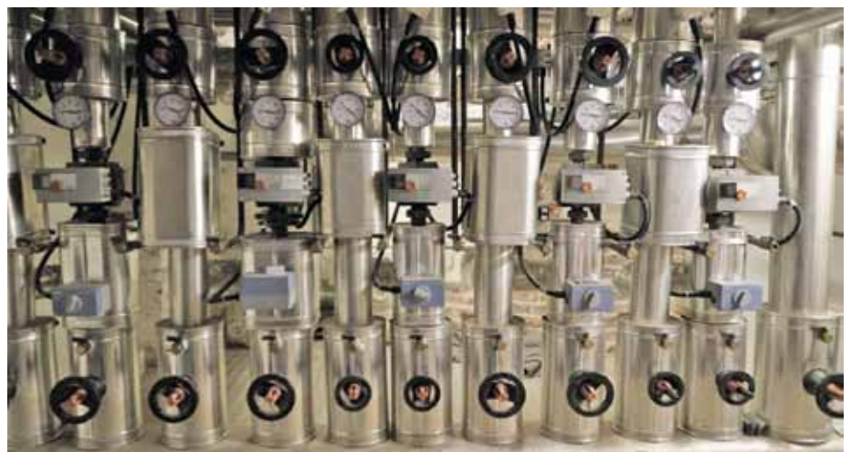
Bild 4: Die Wärmeverteiler in der Krypta.
