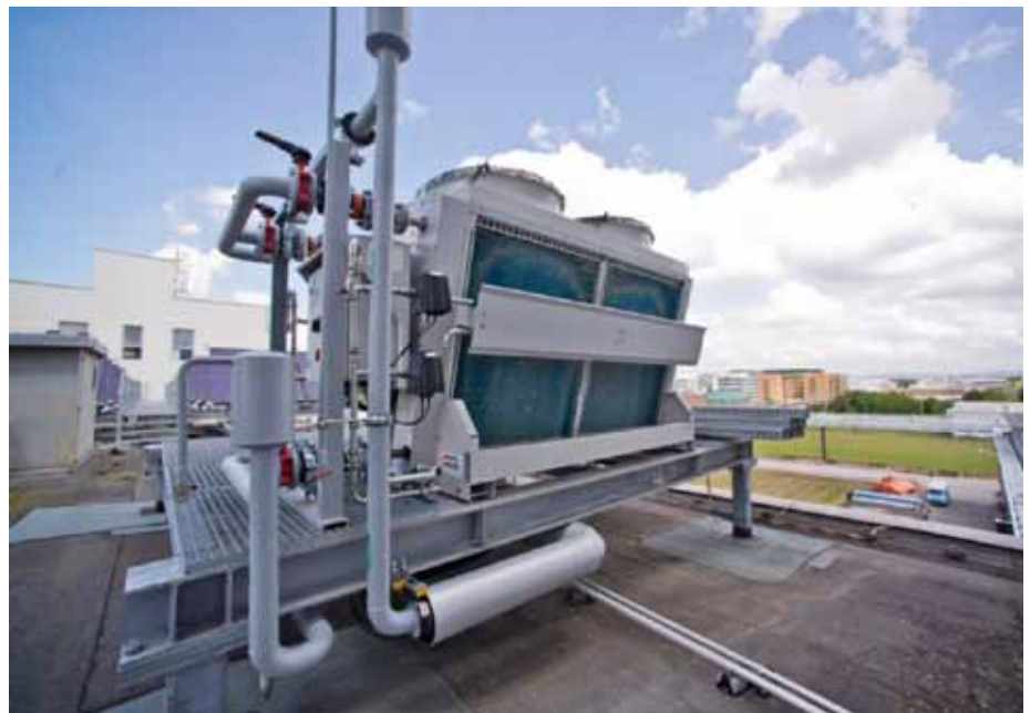
Abb. 3: Luft-Rückkühler auf dem Dach des Bürogebäudes in Mannheim.
