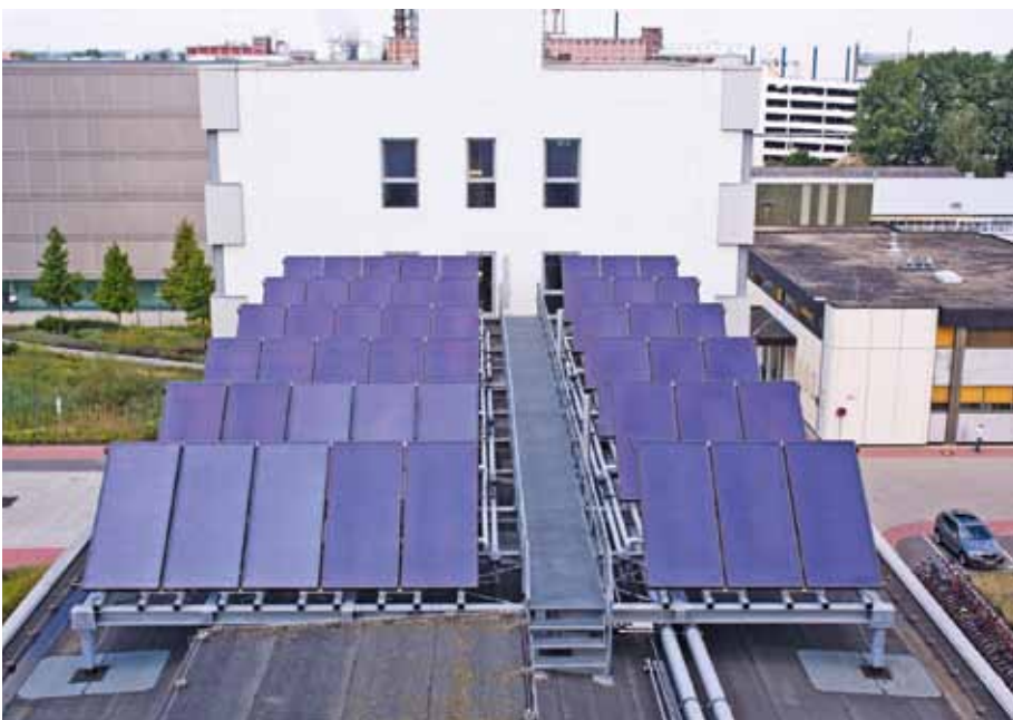
Abb. 1: Solarwärme als Antriebsenergie
