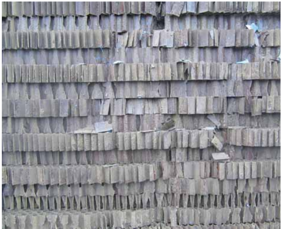
Bild 2: Belastete Packungen einer Anlage.
