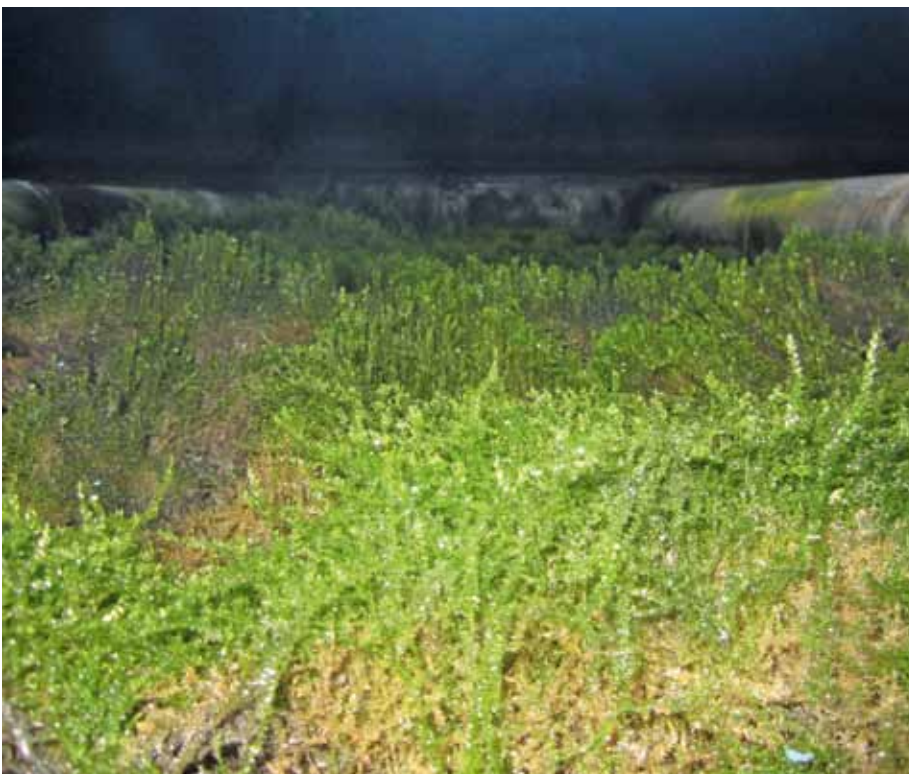
Bild 3: Inneres einer Anlage nach völlig vernachlässigter Instandhaltung.
