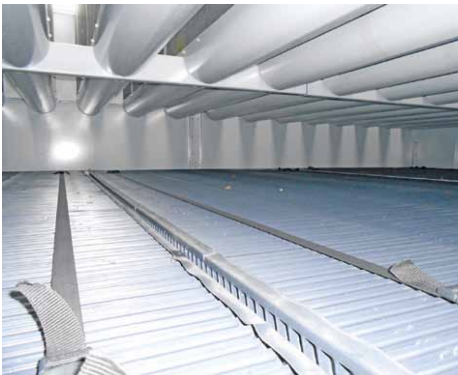
Bild 1: Sauberes Inneres einer neuen Verdunstungsanlage.
