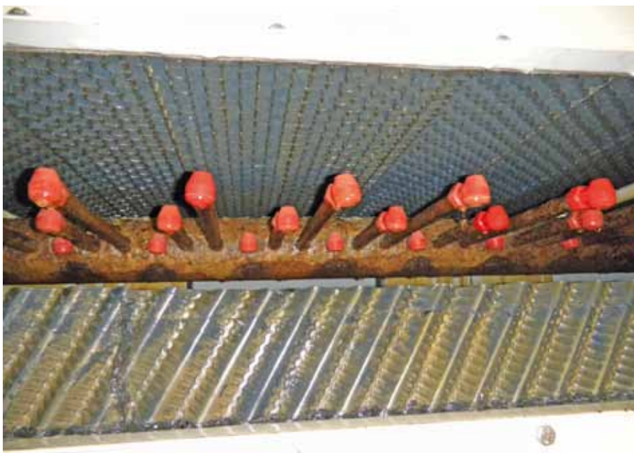
Bild 4: Beispiel für vernachlässigte Instandhaltung einer Anlage.
