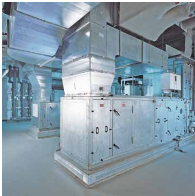
Abbildung 1: RLT-Anlage: Soll eine Kühlung der Zuluft nachgerüstet werden, bietet sich die Integration eines Inverter-Split-Systems an.
