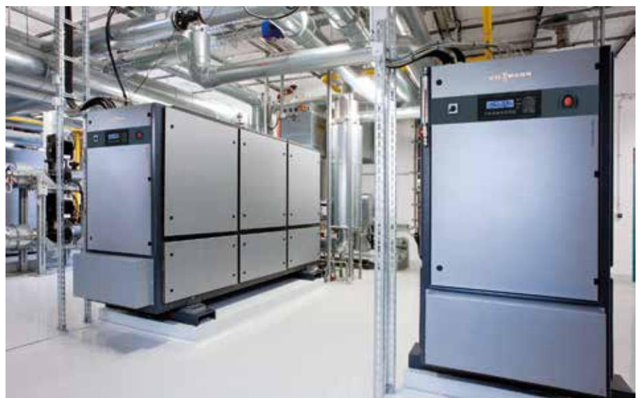
Abbildung 4: Zwei Vitobloc 200 Blockheizkraftwerke mit jeweils 140 Kilowatt elektrischer Leistung im Heizkraftwerk „West 1“ der Stadtwerke Güstrow
