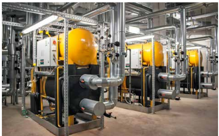
Abbildung 2: Installation mit drei Absorptionskälteanlagen vom Typ „Hummel“
