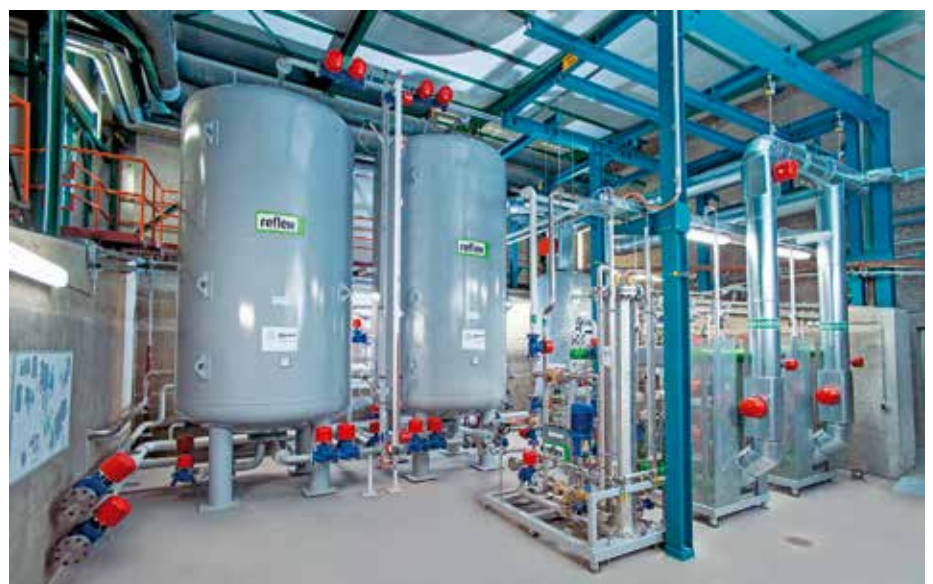
Die neue Druckhalteanlage des Heizwerks „Im Grund“
