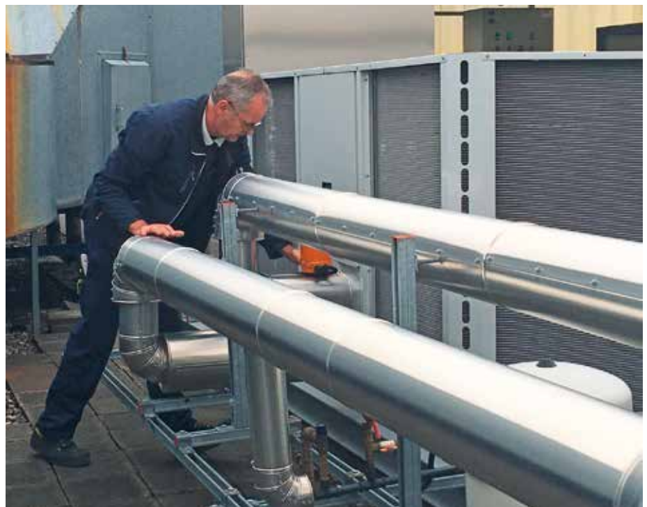
Abbildung 2: Prüfung des Ventils durch den Projektleiter
