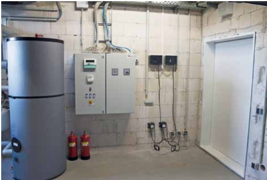
Der Haustechnikraum im Obergeschoss der Grundschule
