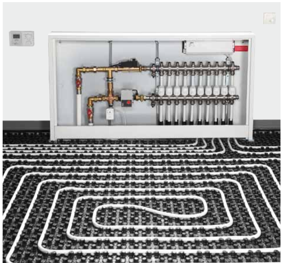
Die Zwei-Punkt-Stellantriebe sind jeweils in einem zentralen Verteiler untergebracht, unauffällig in der Wand und vor Beschädigungen gut geschützt.
