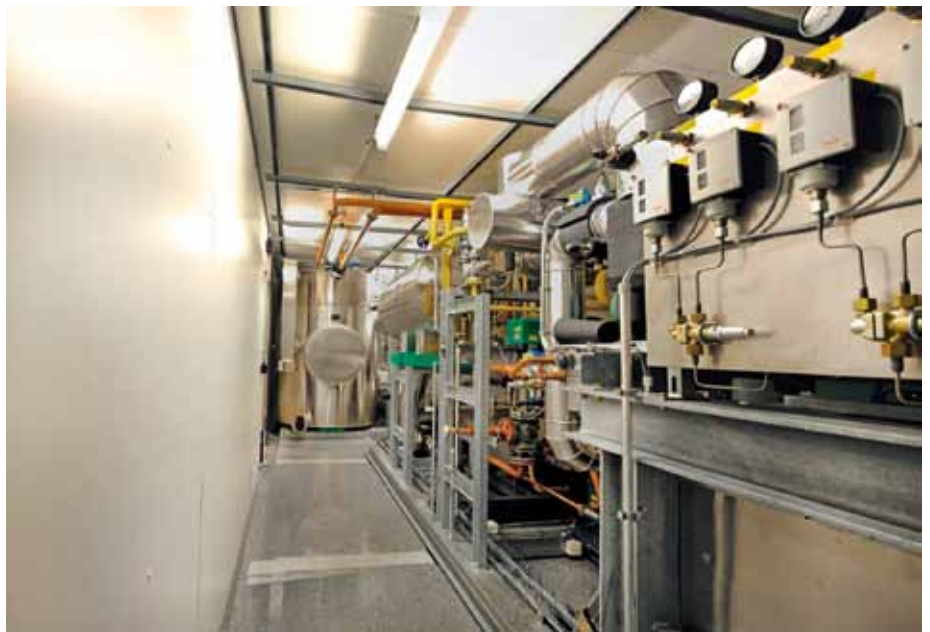
Der Maschinenraum innerhalb des Kältecontainers
