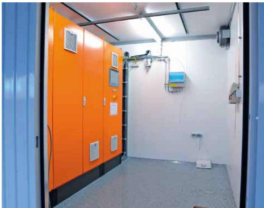
Die komplette Elektronik im Schaltraum des Containers
