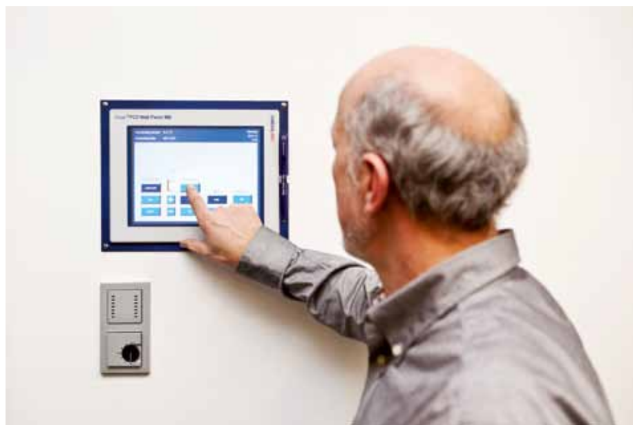
Komfortable Steuerung der Gebäudetechnik über Touchpanel.
