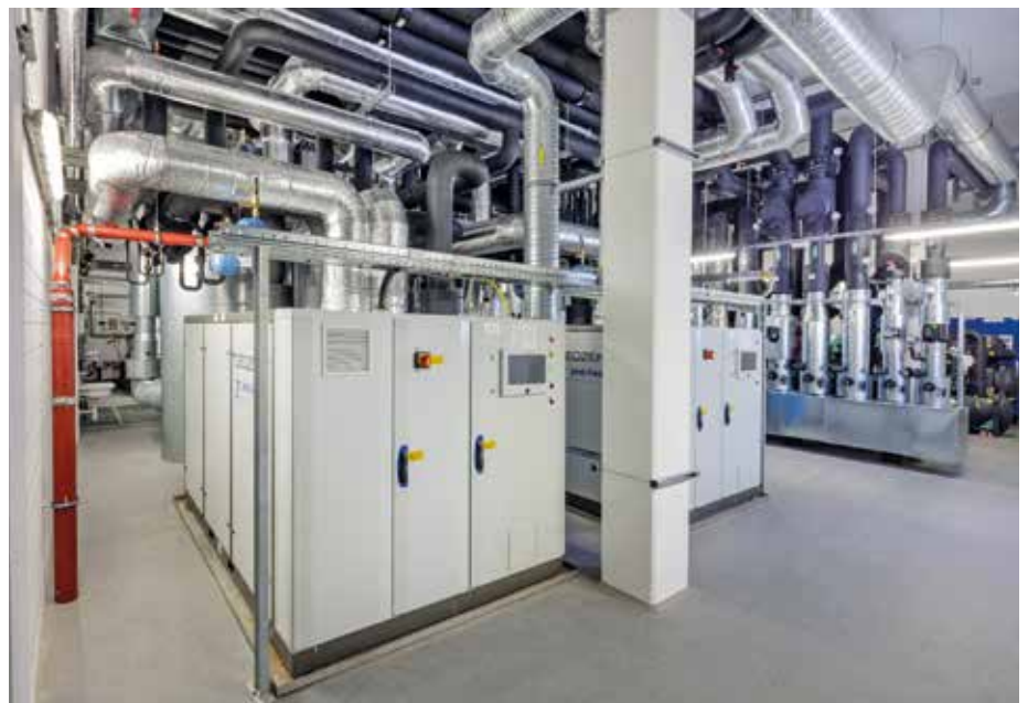
Die beiden maßgefertigten Energiezentralen versorgen mehr als 10.000 m 2 Heiz- und Kühldecken.
