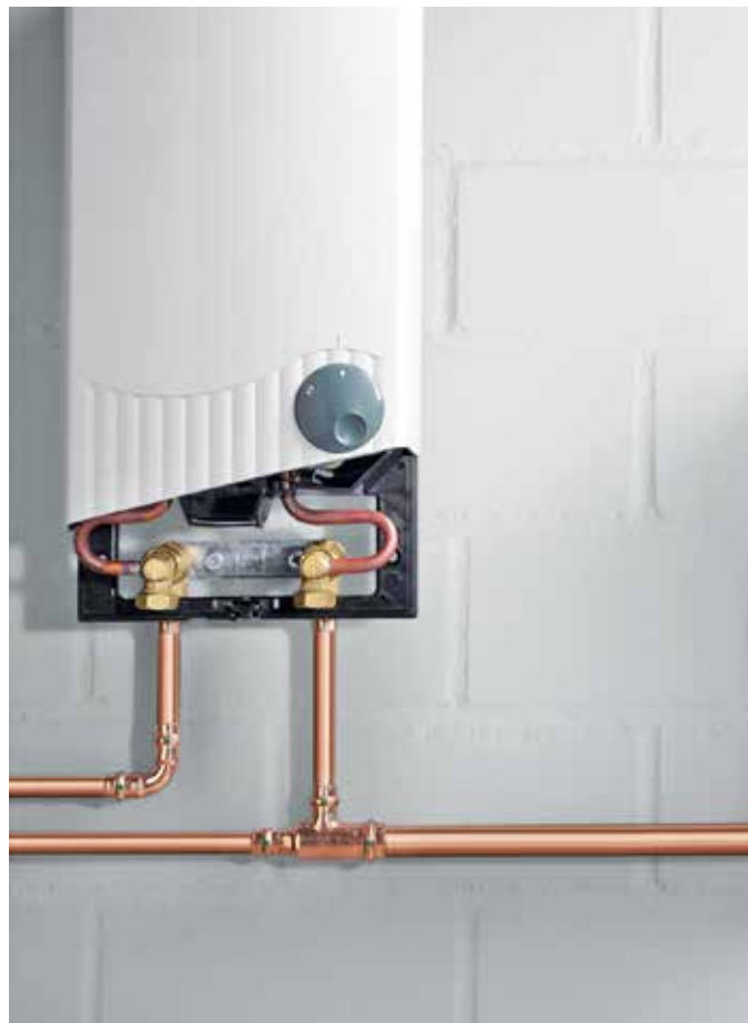
Abbildung 2: Vielfach hatten Durchlauferhitzer den Ruf, Energieeffizienz und Trinkwasserhygiene gut miteinander vereinbaren zu können. Das Umweltbundesamt gab jedoch die Mitteilung heraus, dass auch von dezentralen Trinkwassererwärmern eine potenzielle Gefahr der Verkeimung mit Legionellen ausgeht.
