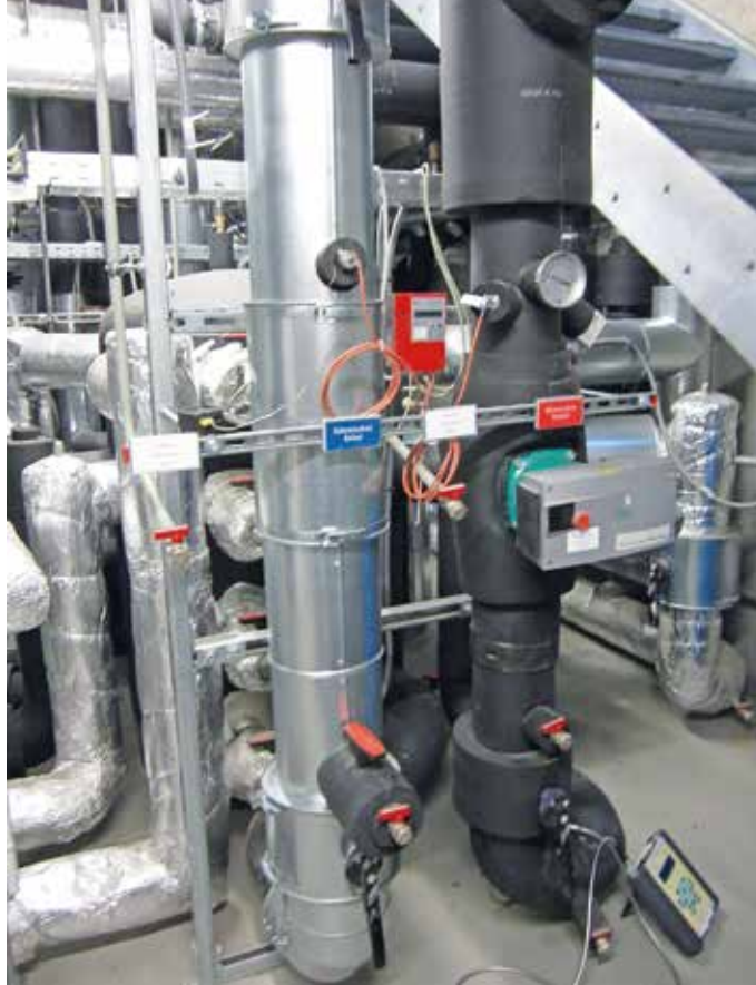
Abbildung 2: Installation von mobiler Messtechnik an einer Testanlage (Ultraschalldurchfluss- messgerät und Anlege- temperatursensoren)
