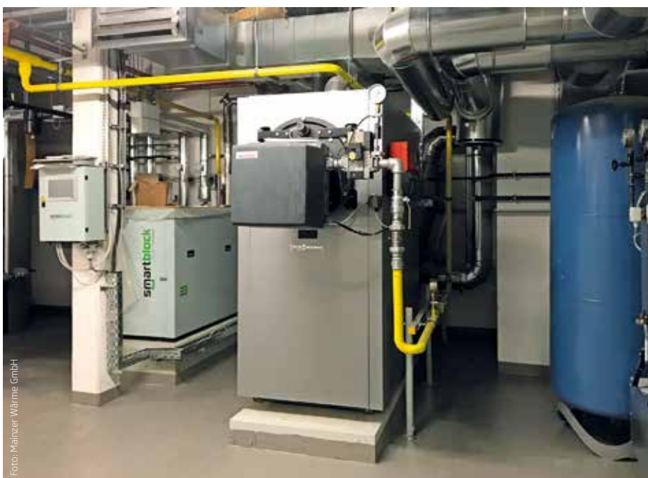
Abbildung 3: Grundbaustein der Wärme- und Energieversorgung der 46 Wohnungen des Quartiers ist ein Blockheizkraftwerk.
