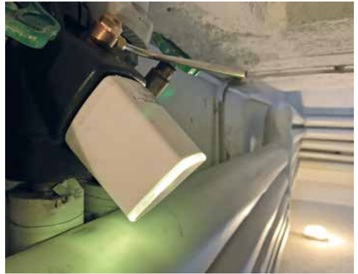
Zur Sicherstellung eines konstanten hydraulischen Abgleichs konnten die Stränge der Bestandsanlage unkompliziert mit intelligenten Zirkulationsventilen nachgerüstet werden.
