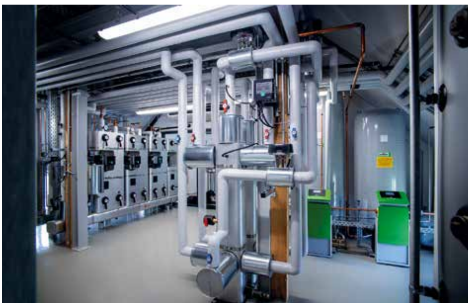
Die Gesamtanlage muss fehlerfrei und redundant laufen, da der Hof auf eine zuverlässige Energieversorgung angewiesen ist.
